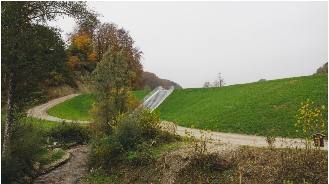
Abbildung 26: Wasserseitige Ansicht Abschlussbauwerk mit Schwemmholzrechen Chappelenbach Wynigen, V \sim 86'000 \text{ m}^3 , Foto: K+Z AG
